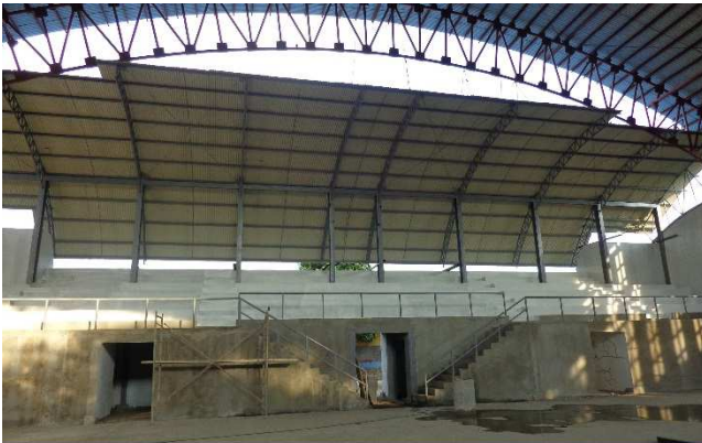
Se aprecia fachada principal de la gradería, con las etapas de paredes, graderías, techos y fascias.
