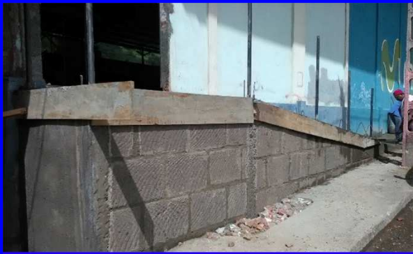
Construcción de rampa para acceso a los deportistas en costado norte del Gimnasio de la Trinidad.
